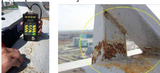
Рис.5 – Лакокрасочное покрытие всех элементов металлической короны отсутствует, либо нанесено поверх неподготовленной поверхности, наблюдаются очаги язвенной коррозии
