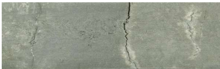
Рисунок 1 – Горячие трещины в стенке отливки газовой арматуры материал – хромоникелевая сталь с 15%Cr и 6%Ni, толщина стенки отливки 70 мм
