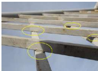
Рис.4 – Многочисленные дефекты монтажа металлических конструкций
