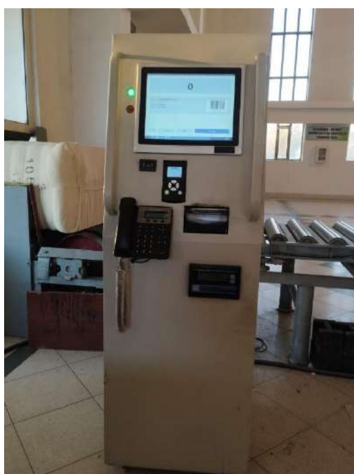
Рисунок 1 – Пультовое устройство установлено в ХПЗ “Гиждувона” Бухарской области
