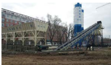
Рисунок 1 – Общий вид бетоносмесительной станции HZS90
