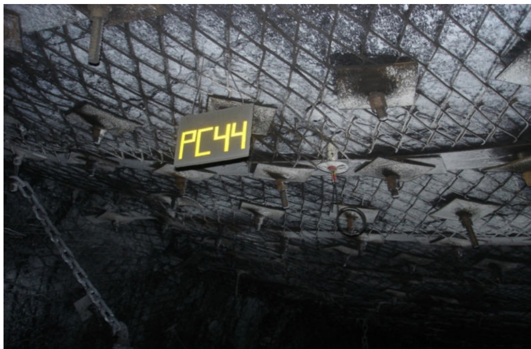
Рисунок 2.8 – Состояние закрепленных пород кровли конвейерного штрека 40к 7 -в шахты им. Костенко
