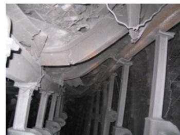
Дефектность горных выработок
